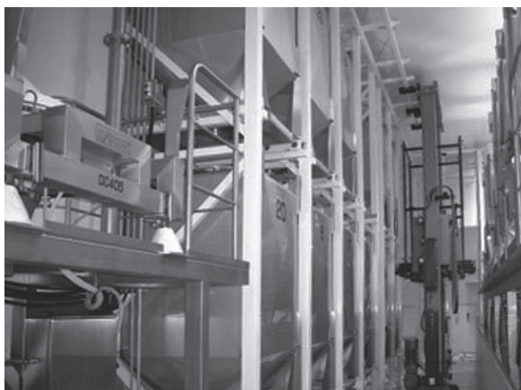
図6 保管棚とスタッカークレーン
