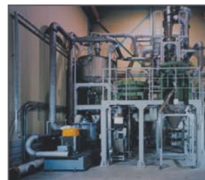
プラント外観
